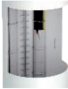
Bandázsolt kábelhágcsó egy szél-turbinában
