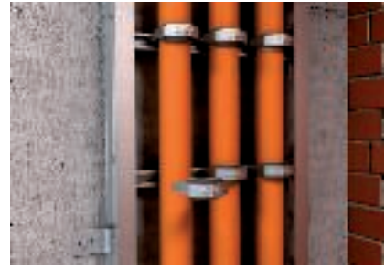
Kábelrögzítés kenyeles bilincsekkel a kábelhágcsó fokain
